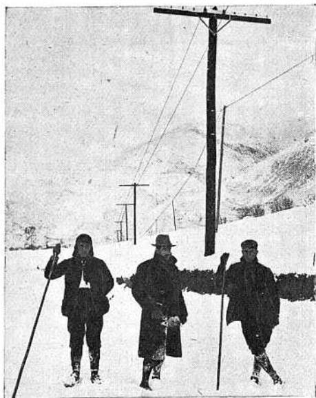
Después de Salardú y Tredós, la línea con un solo circuito, que viene del Puerto de la Bonaigua, con las crucetas cubiertas de nieve.
